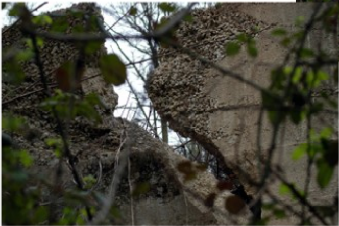
Particolare di una delle rotture, ma non ci dovrebbe essere del ferro?
