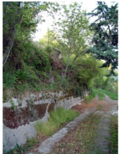
Sotto il muro pericolante c'è una strada che porta a delle abitazioni
